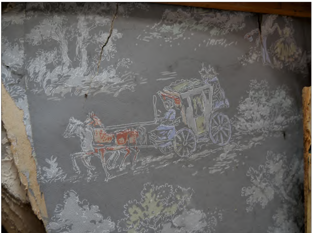
Abb. 4 Lübeck, Petersilienstraße 8, Obergeschoss, bedruckte Tapete – HL/Abt. Denkmalpflege/Lutter/2024.
