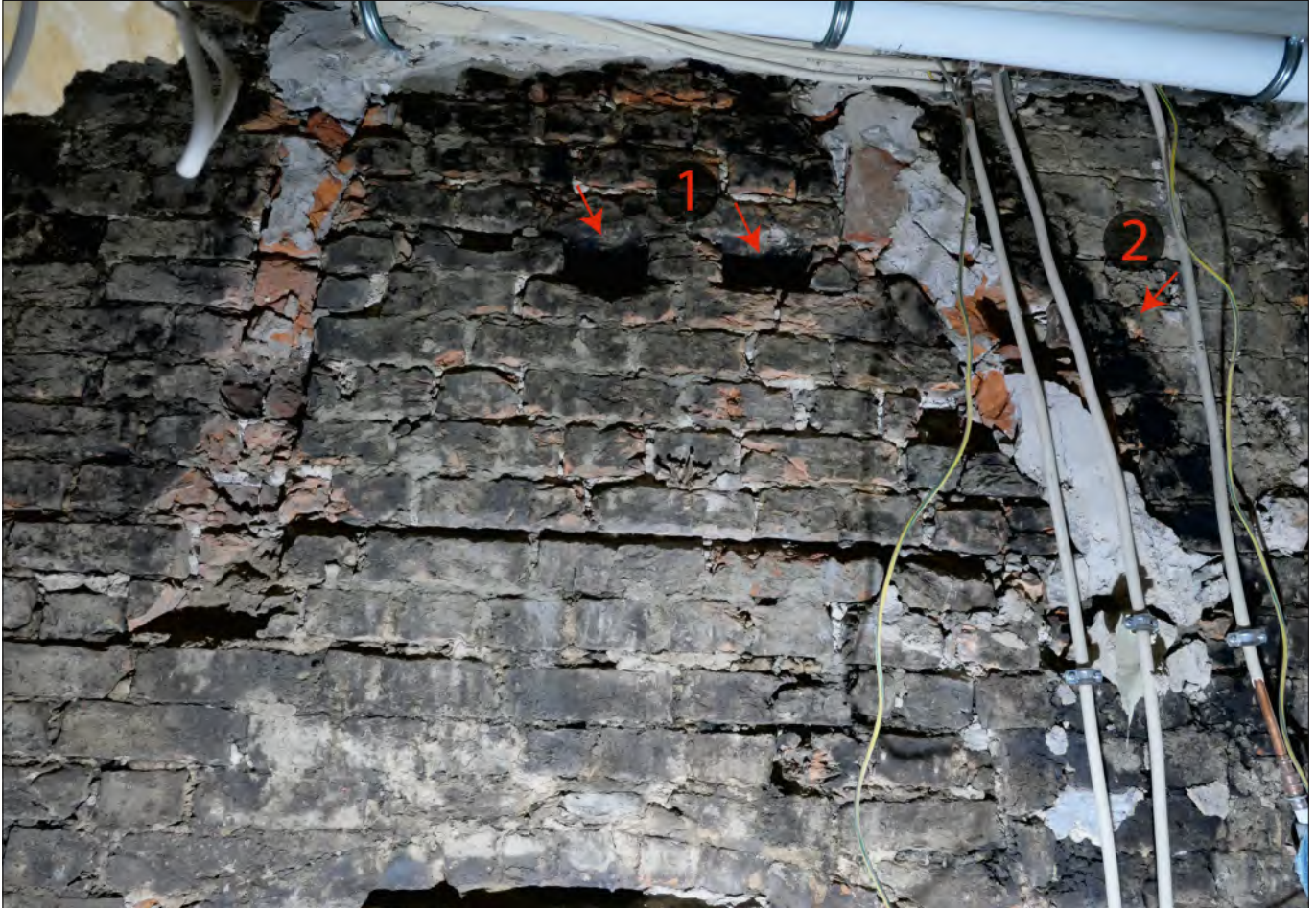
Abb.7 Lübeck, Kupferschmiedestraße 10, Mauerbefund über dem Segmentbogen mit Löchern (1) und Rußspur (2) – HL/Abt. Denkmalpflege/Krischke/2024.
