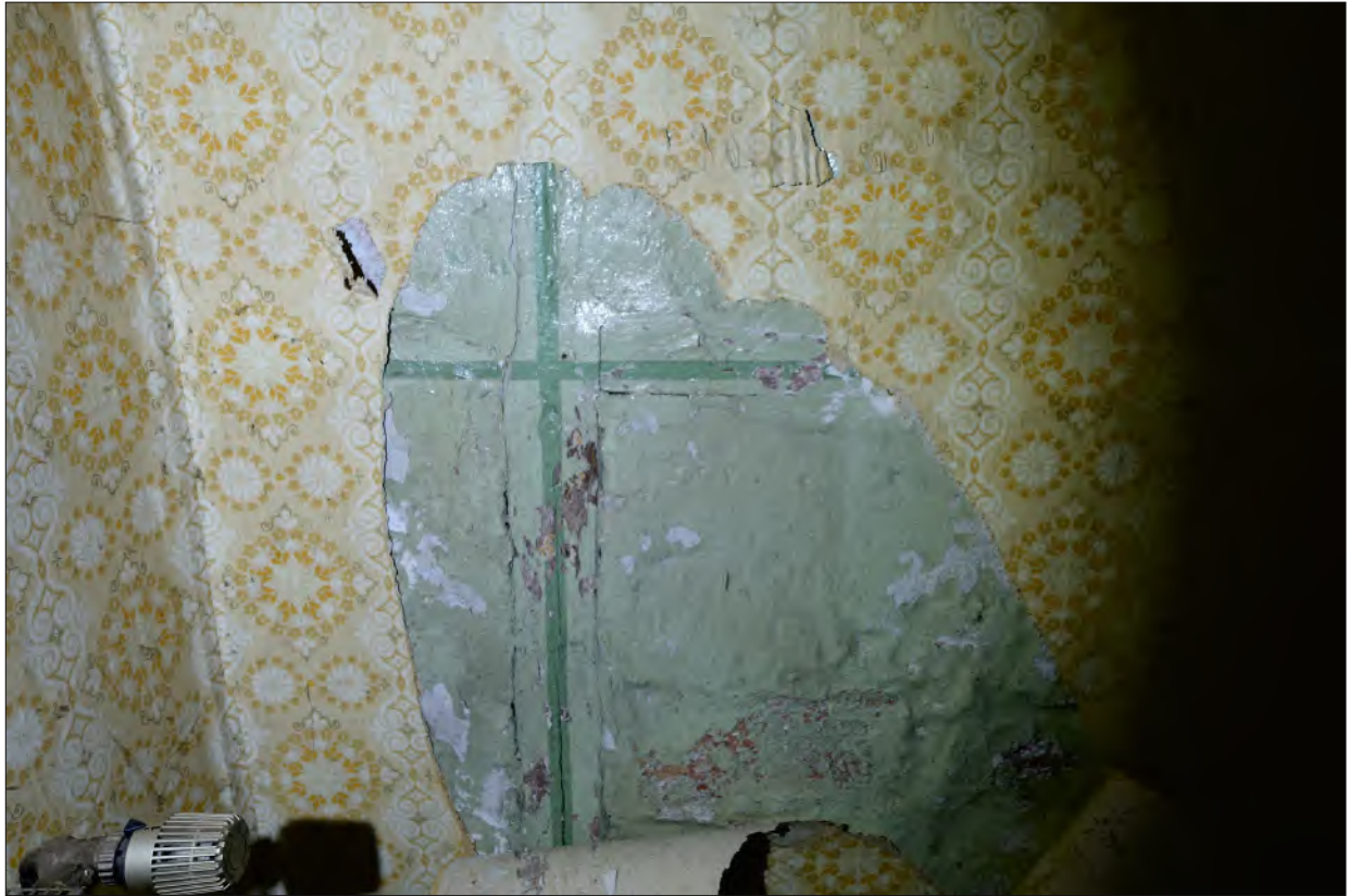
Abb. 3 Lübeck, Petersilienstraße 8, Obergeschoss, Befunde unter Tapete – HL/Abt. Denkmalpflege/Lutter/2024.
