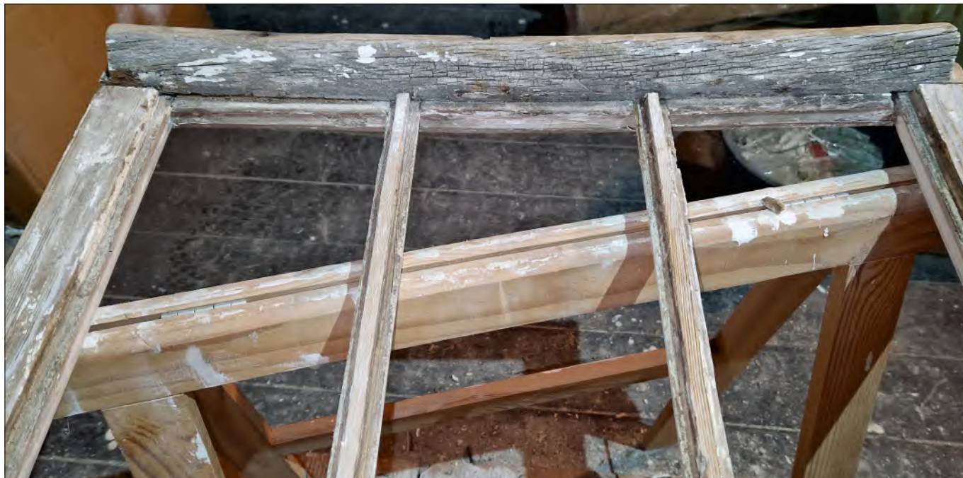
Abb. 3 Beispiel für einen Holzrahmen, der gründlich aufgearbeitet werden musste. Außen war die Farbe verwittert, der Rahmen und Wetterschenkel unten deshalb Sonne und Regen schutzlos ausgeliefert. Das ausgelaugte Holz hatte sich bereits stark verzogen. Hier mussten, wie bei den anderen Dachgeschossfenstern auch, der Kitt und Anstrich komplett erneuert werden – Kiefer/Sellerbeck/2024.
