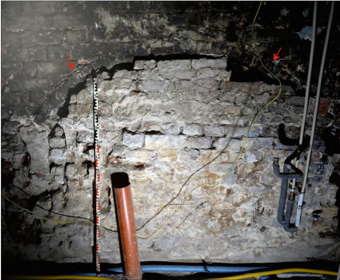
Abb.5 Lübeck, Kupferschmiedestraße 10, Mauerbefund mit Segmentbogen (s. Markierung) – HL/Abt. Denkmalpflege/Krischke/2024.
