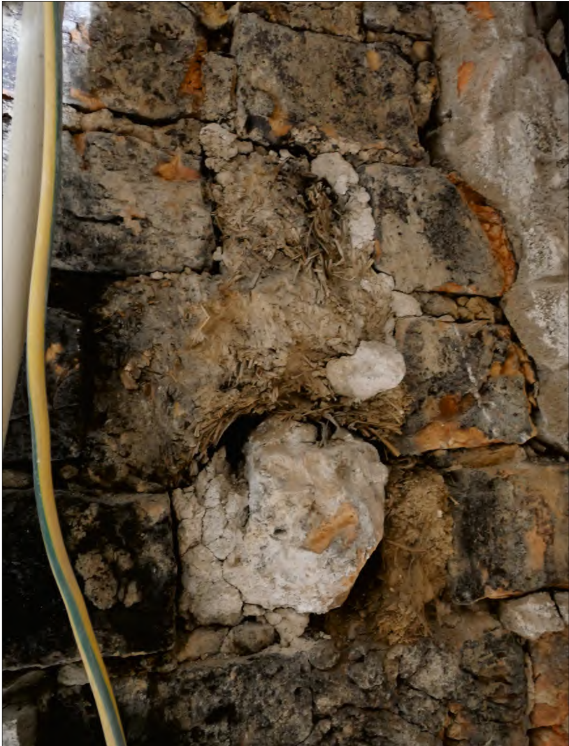
Abb.8 Lübeck, Kupferschmiedestraße 10, Reste des Lehmputzes mit Strohmagerung – HL/Abt. Denkmalpflege/Krischke/2024.
