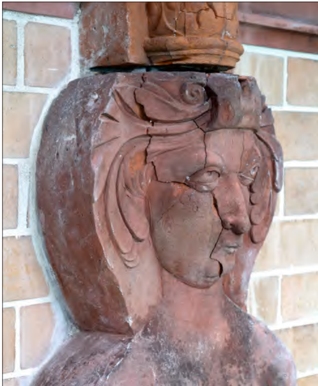
Abb. 8 Lübeck, Musterbahn 3, Straßenfassade, Kopf eines Hermenpilasters vor der Instandsetzung; die Fugen sind ein typisches Zeichen einer Rostsprengung – HL/Abt. Denkmalpflege/Knipscheer/2024.
