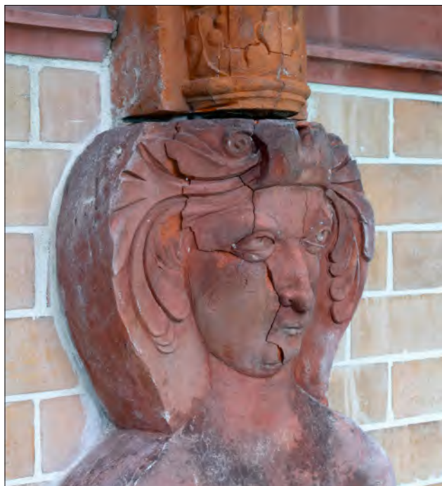
Abb. 2 Lübeck, Musterbahn 3, Straßenfassade, Kopf eines Hermenpilasters mit deutlich sichtbaren Rissen – HL/Abt. Denkmalpflege/Knipscheer/2024.
