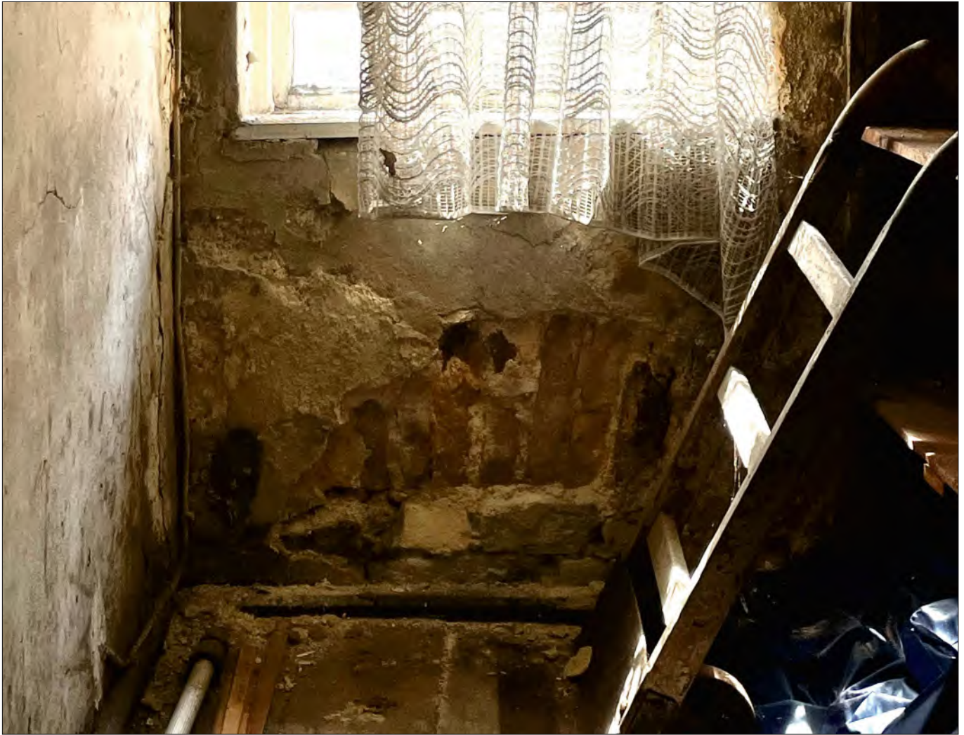
Abb. 6 Lübeck, Beckergrube 76, Segmentbogen im Fassadenmauerwerk – TH Lübeck/Blume/2024.
