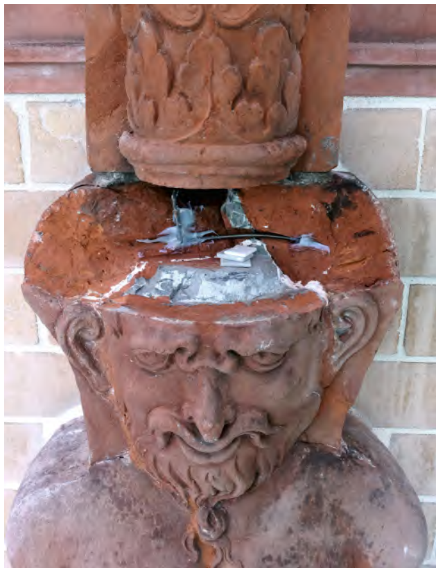
Abb. 5 Lübeck, Musterbahn 3, Straßenfassade, Hermenkopf nach dem Abnehmen der losen Terrakottateile, Entrosten des historischen Ankers und Einkleben eines neuen Edelstahlankers aus Gewindestahl – HL/Abt. Denkmalpflege/Knipscheer/2024.
